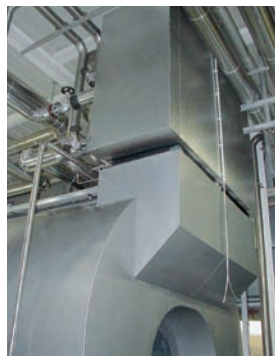
Надстраиваемый экономайзер парового котла Vitomax 200-HS
