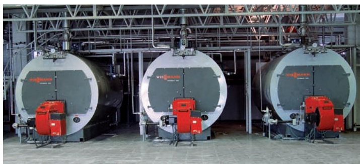
Паровая котельная в Стамбуле, Турция
