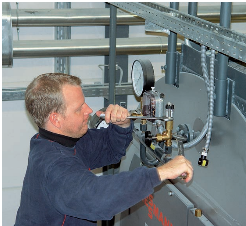
Техническое обслуживание котла
